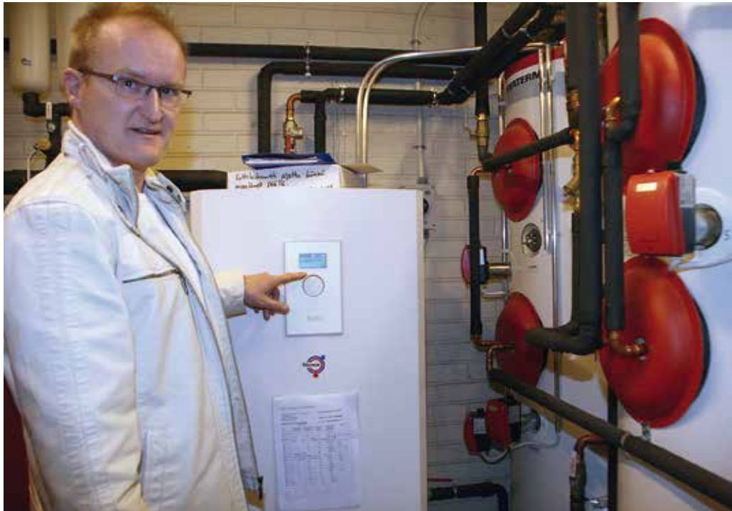
Asunto Oy Rantapajun hallituksen puheenjohtaja Ari Honkanen näyttää, millainen on maalämpöpumppu. Oikealla lämminvesivaraajat.
