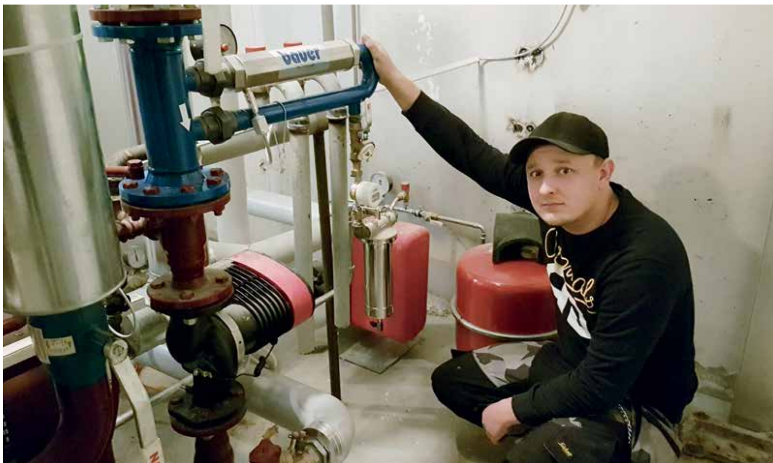
Kuvassa on kiinteistöhoitaja Lauri Vilmunen Etelä-Pohjanmaan Kiinteistöhuolto Oy:stä, joka on Ylisenhaan kiinteistöhoitoyhtiö. Lauri on vaihdellut taloyhtiössä Bauerin vedenkäsittelylaitteen suodattimia.
