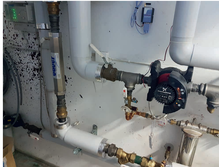
Bauer asennetaan osaksi lämmitysverkostoa ja sivuvirtasuodatin pumpun rinnalle.
