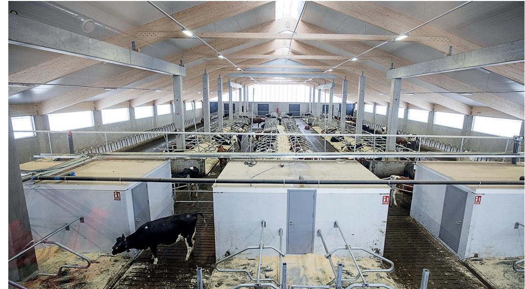
Navetan ilmanvaihto on painovoimainen, eli kennonlevyseinät ja katon valoharja käännetään manuaalisesti auki. Katossa on ledi-valot. Säästöä syntyy himmennustekniikasta. Valojen himmentäminen yöksi auttaa myös karjaa rauhoittamaan uneen.
